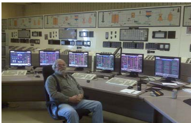
Salle de contrôle / Control Room
